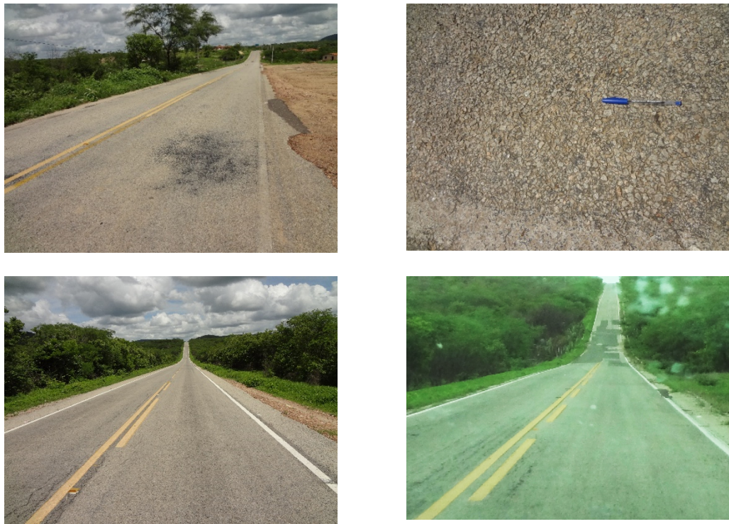
Figura 9. Vista geral do trecho, detalhe da textura, presença de trincas e remendos (CHR-BR020)
