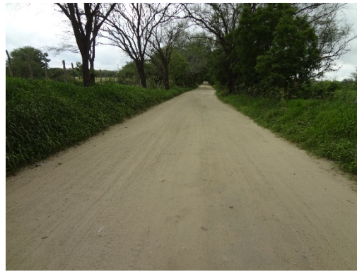
Figura 12. Via Não Pavimentada - Trecho TEOTONIO
